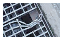
除雪ブレードによる破損
